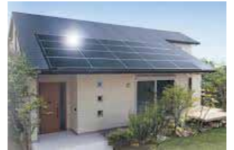
太陽光発電システム
